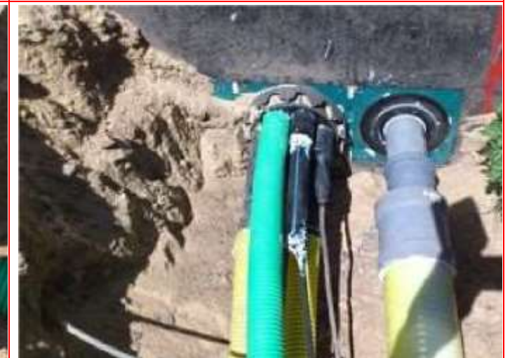
Nya DC ledningar längst till höger in i "Kiosken"
