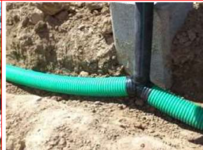
DC ledningar i skyddsror vid fundament
