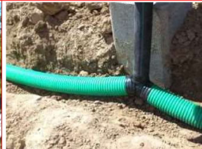
DC ledningar i skyddsror vid fundament
