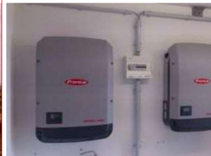
Växelriktarna monterade i "kiosken"
