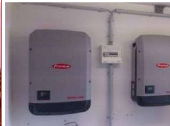
Växelriktarna monterade i "kiosken"
