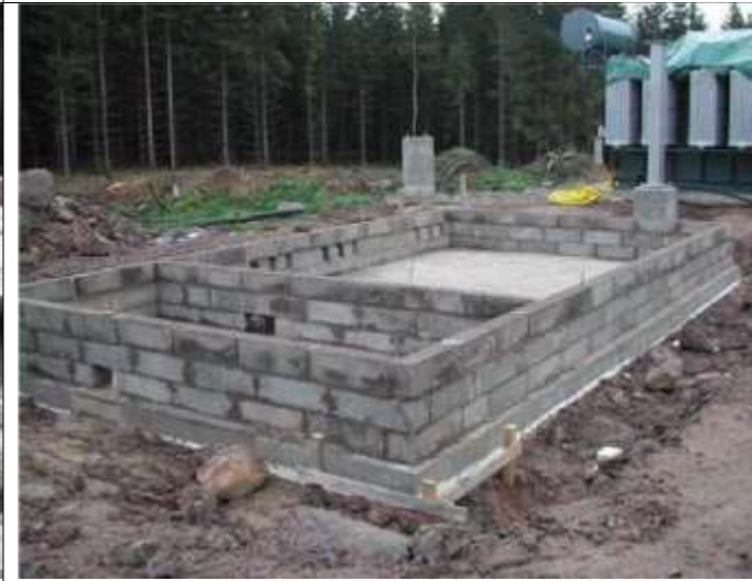
Grund till ställverk
