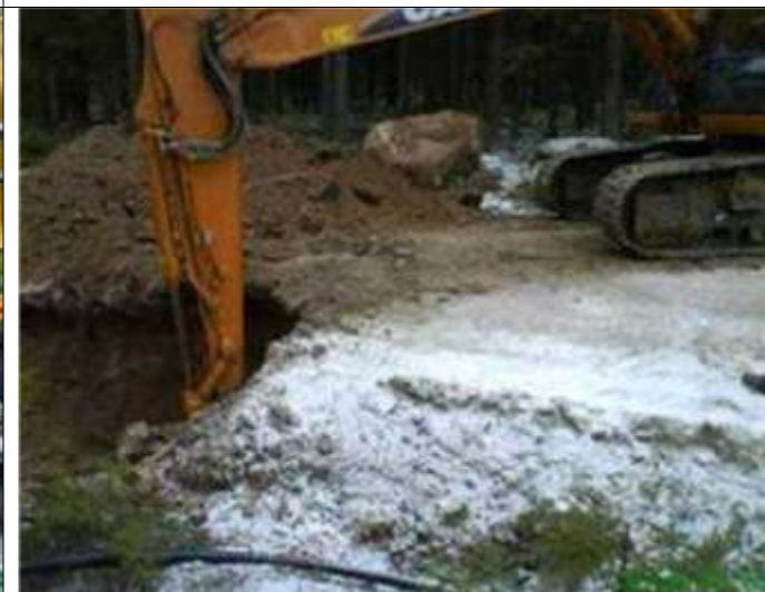
Tjäle vid passage av väg
