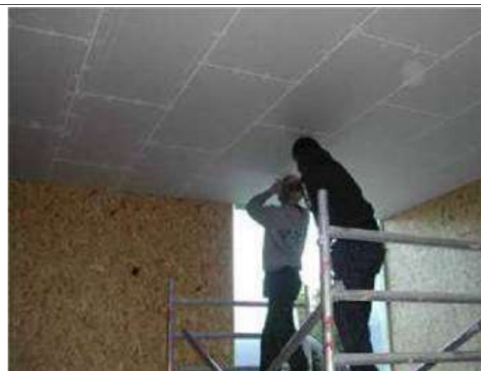
Innertak i ställverket Hans och Johan
