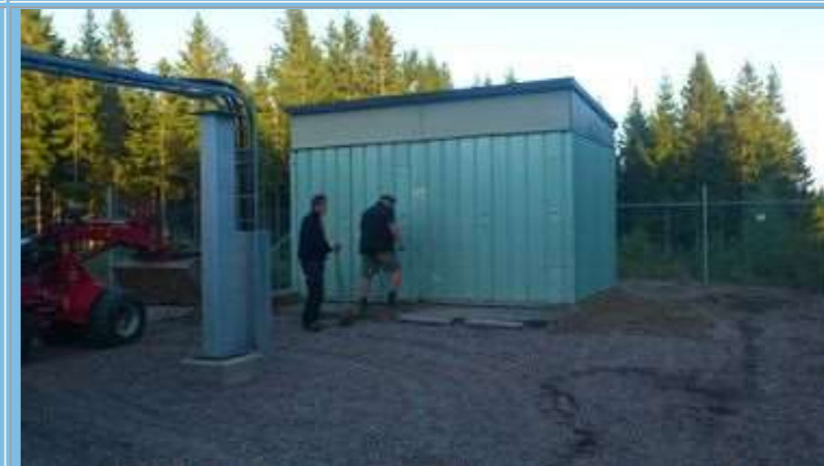
Christer och Anders tätar runt ställverket för att förhindra att djur tar sig in
